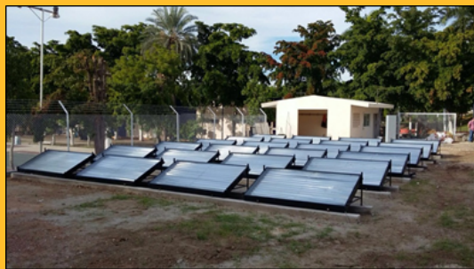
Figura 3. Banco de concentradores instalado en el ITS.
